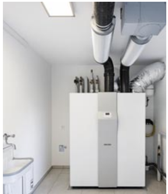
Außer Verteilerschrank und Wechselrichter befinden sich im Technikraum noch der Hausakku (nicht im Bild) und das Kompaktgerät mit Wärmepumpe zum Lüften, Heizen und Kühlen.
